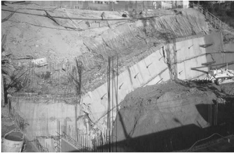
Fig. 10 - Estrutura de contenção tipo Berlim após rotura.
