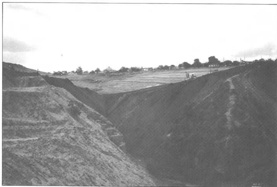
Foto 2 - Processo de recuperação da área da feição mostrada na Foto 1, iniciado em Dezembro de 1991.
