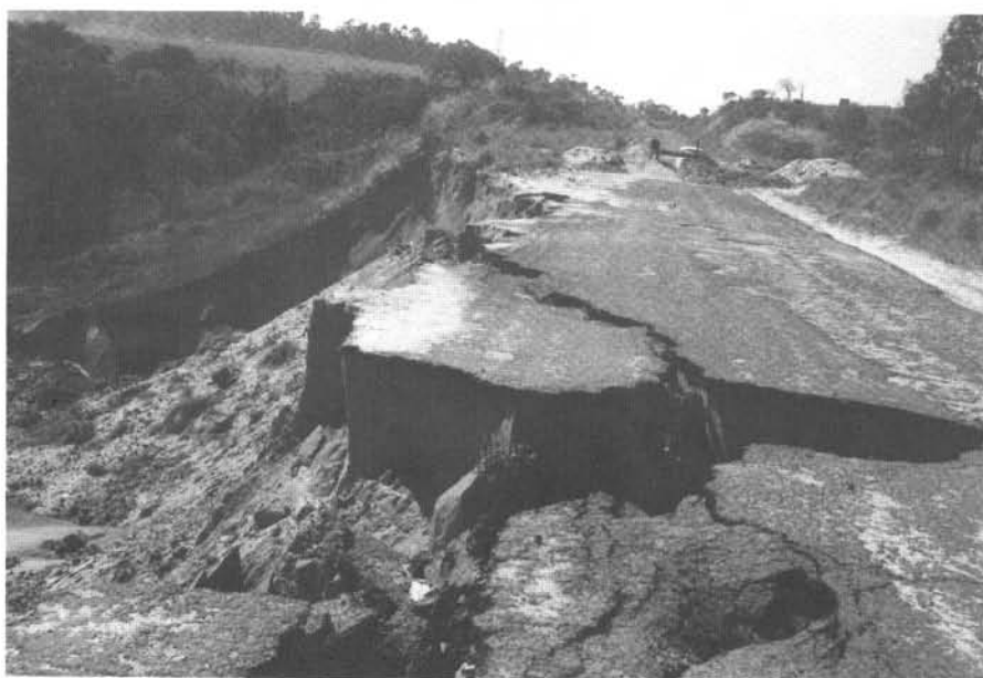
Foto 9 - Vista da estrada totalmente destruída, devido ao rompimento do aterro.
