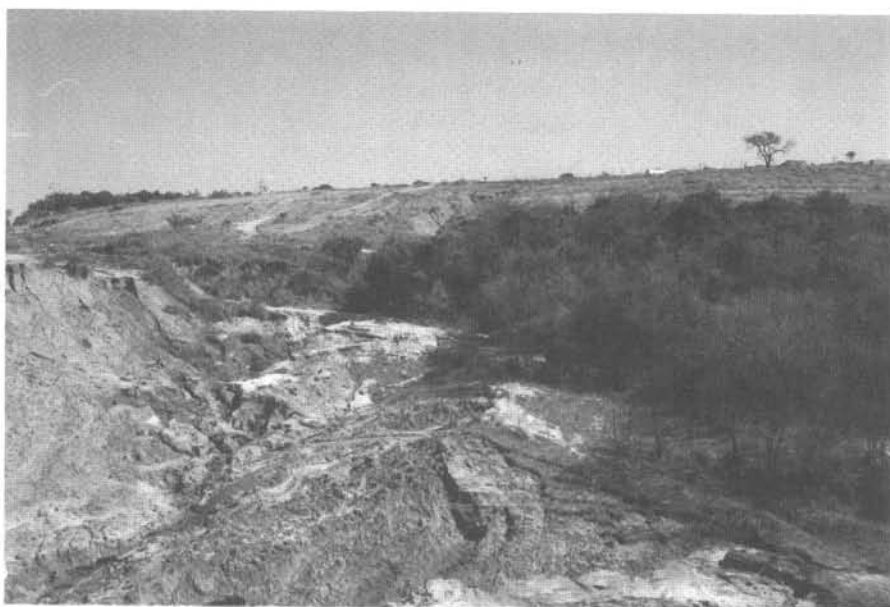
Foto 8 - Degradação da área e da vegetação devido ao acúmulo de água, que atingiu alturas superiores a 3 m.
