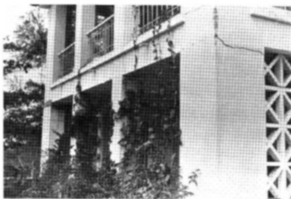
Fig. 1 – Exemplos do fendilhamento de edifícios fundados em solos expansivos de Angola
