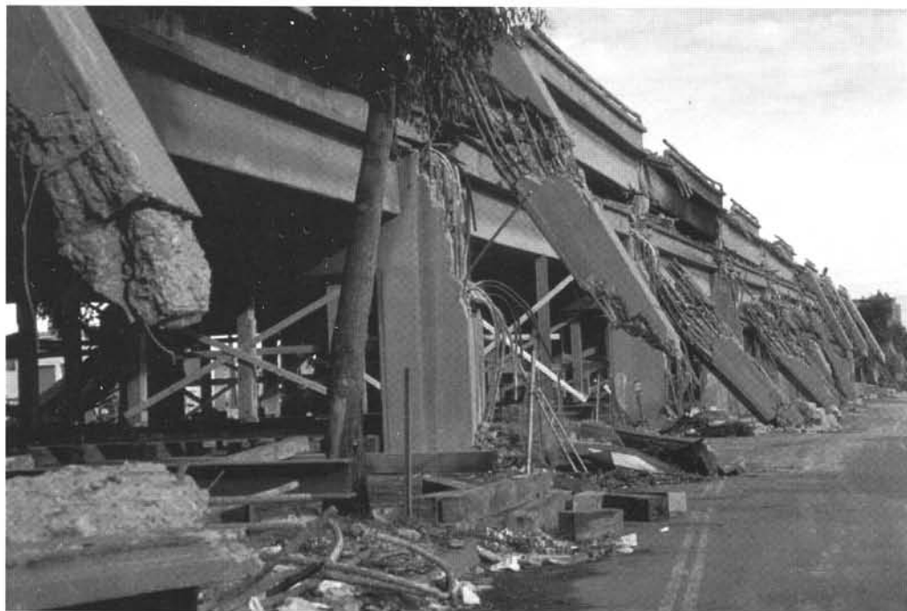
Fig. 25 – Colapso de viaduto rodoviário perto de Oakland no sismo de Loma Prieta, 1989-10-19, EUA (Fonte: United States Geological Survey , EUA – http://geopubs.wr.usgs.gov ).
