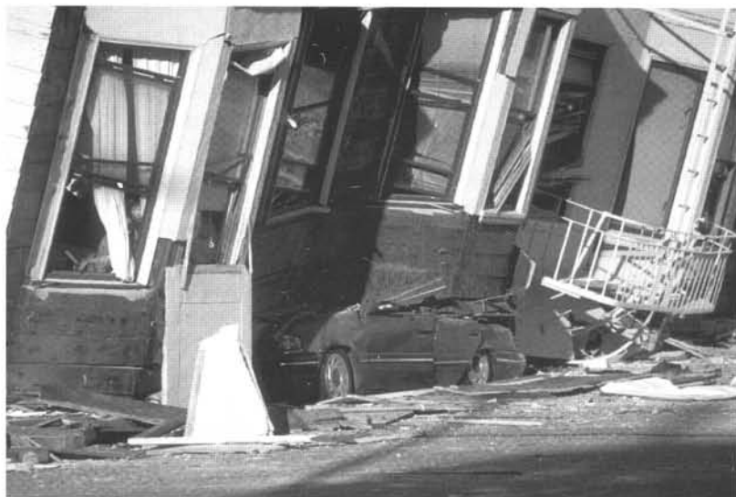
Fig. 23 – Colapso de edifício na cidade de S. Francisco no sismo de Loma Prieta, 1989-10-19, EUA (Fonte: United States Geological Survey – http://geopubs.wr.usgs.gov ).
