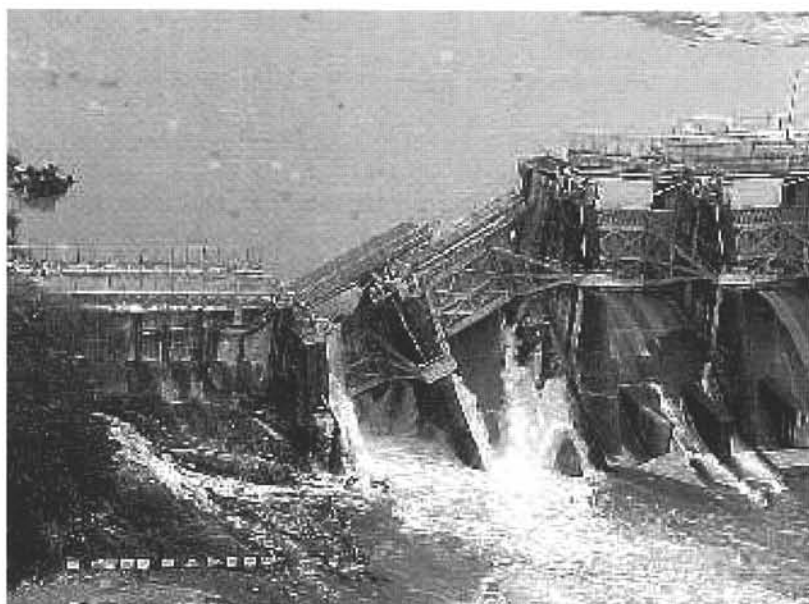
Fig. 8 – Colapso de barragem devido a grandes deslocamentos diferenciais impostos à superfície por rotura da falha de Chelungpu no sismo de Ji-Ji, 1999-09-20, Taiwan (Fonte: Universidade da Califórnia, Berkeley, EUA – http://nisee.berkeley.edu ).
