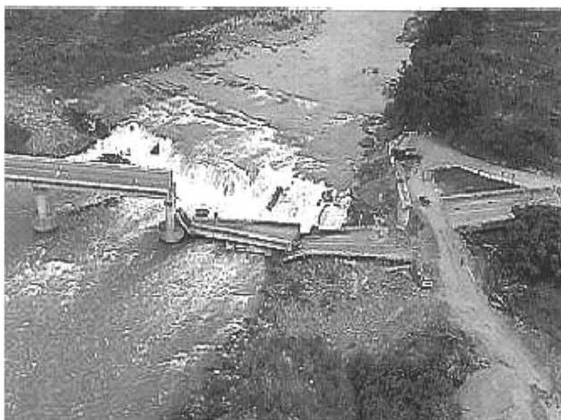
Fig. 9 – Colapso de ponte devido a grandes deslocamentos diferenciais impostos à superfície por rotura da falha de Chelungpu no sismo de Ji-Ji, 1999-09-20, Taiwan (Fonte: Universidade da Califórnia, Berkeley, EUA – http://nisee.berkeley.edu ).
