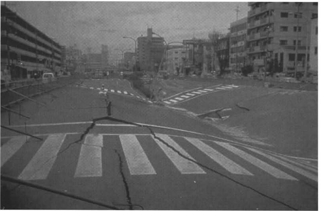
Fig. 6 – Grande abatimento de arruamento na cidade de Kobe, causado pelo colapso parcial de uma estação de Metro subjacente, no sismo de Kobe, 1995-01-17, Japão (Fonte: Universidade da Califórnia, Berkeley, EUA – http://nisee.berkeley.edu ).
