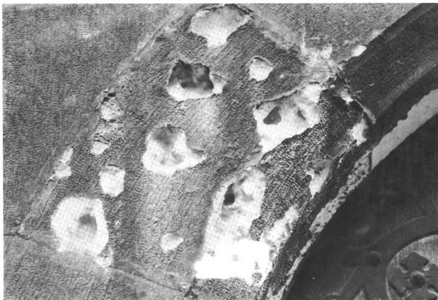
Fig. 2 - Crostas negras na Sé de Lisboa. A sulfatação da camada superficial da pedra produz uma crosta endurecida e frágil que se destaca do substrato. Com o seu desaparecimento, são também eliminados os eventuais traços deixados pela mão do canteiro.
