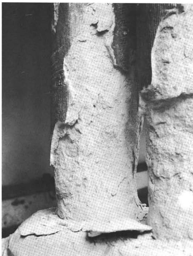
Fig. 4 - Convento de Celas (Coimbra). Os riscos de colapso estrutural podem exigir intervenções que sacrificam a componente estética e a autenticidade do objecto.
