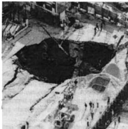
Fig. 2 - Colapso de túnel em São Paulo (Neto e Kochen, 2000)
