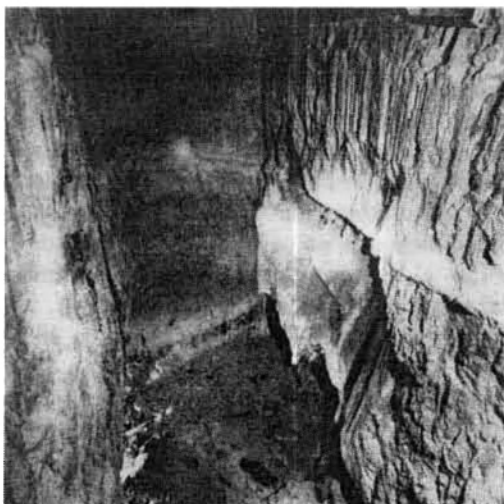
Fig. 10 - Acidente ocorrido na chaminé de equilíbrio (Rocha, 1977)
