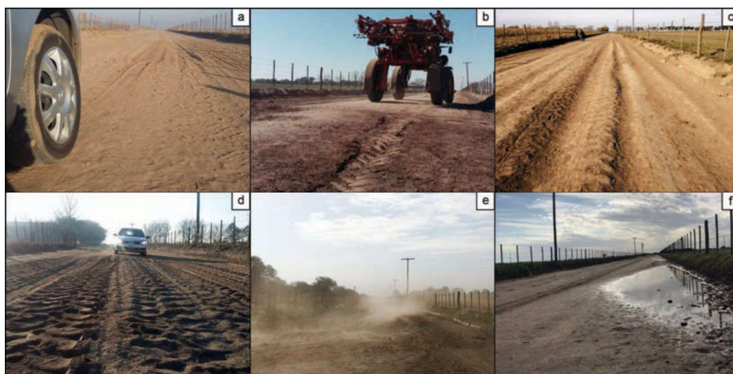
Fig. 1 – Patologías de subrasantes no pavimentadas limo-loésicas: a) suelo friable al tacto; b) falta de bombeo transversal; c) ahuellamiento excesivo; d) carcavamientos localizados; e) polvo en suspensión; y f) zonas inundables.
