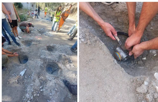
Fig. 15 – Localização e instalação dos sensores no terreno.
