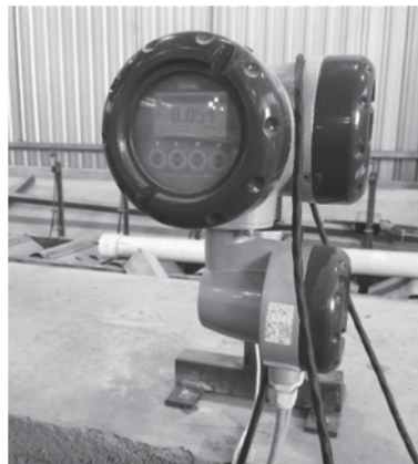
Fig. 5 – Medidor de vazão.
