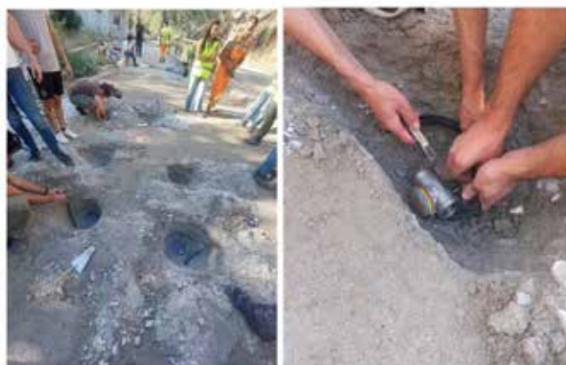
Fig. 15 – Localização e instalação dos sensores no terreno.
