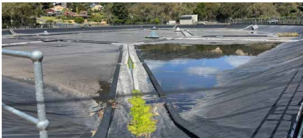
Fig. 12 – Acumulação de sedimentos na caleira com desenvolvimento de vegetação.
