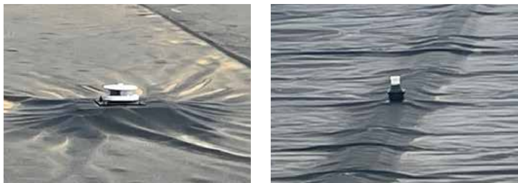
Fig. 9 – Ventilador dinâmico à esquerda e válvula de pressão máxima à direita.
