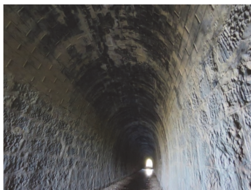
(a) Trincas no trecho do emboque
