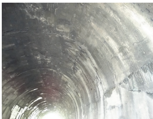
(b) Trincas abertas na parede e abóbada
