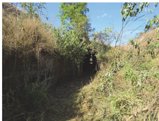
(b) Ruptura do maciço e desemboque
