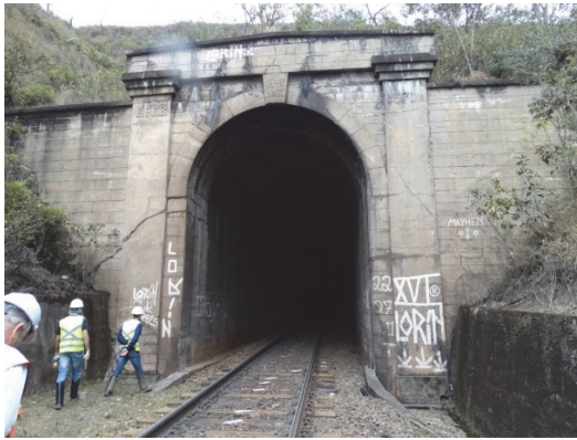
(a) Emboque com trincas inclinadas nas 2 laterais
