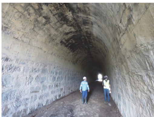
(b) Trincas no trecho do desemboque
