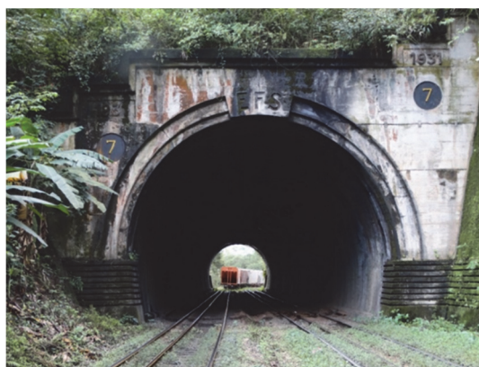
(a) Trincas inclinadas e de juntas - Emboque
