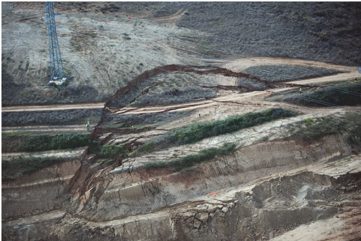
Fig. 29 – Rotura del desmante de Sabadell en limolitas y argilitas terciarias del Vallés, Barcelona.
