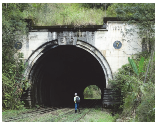
(b) Trincas inclinadas e de juntas - Desemboque
