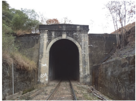
(b) Desemboque com trincas na lateral esquerda
