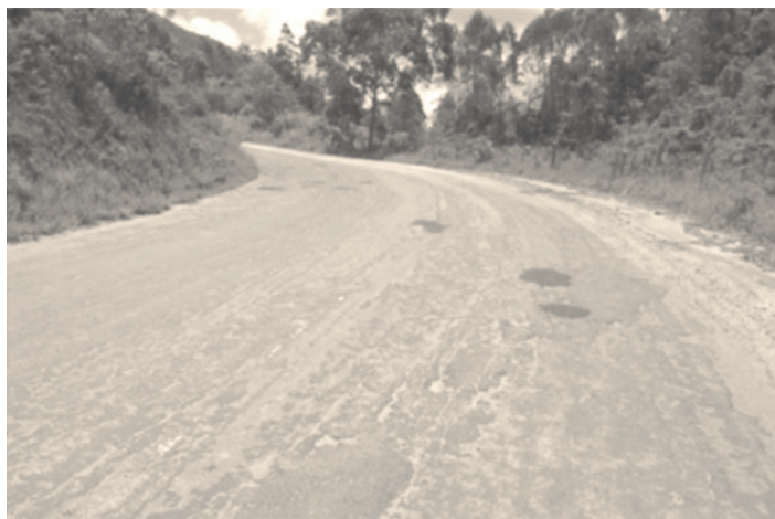
Fig. 1 – Estado de conservação da rodovia da RJ-148 construída em 1979 com base de solo-emulsão (Thuller, 2005).
