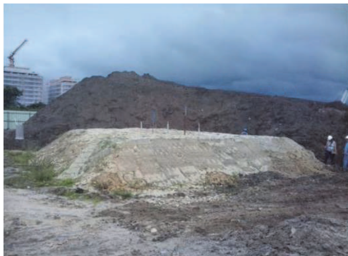
Fig. 19 – Material de descarte depositado próximo ao aterro teste sem tratamento
