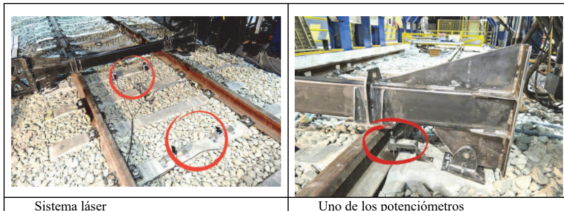
Fig. 5 – Vista de los elementos del sistema de medición, una vez instalados en la traviesa de ensayo.
