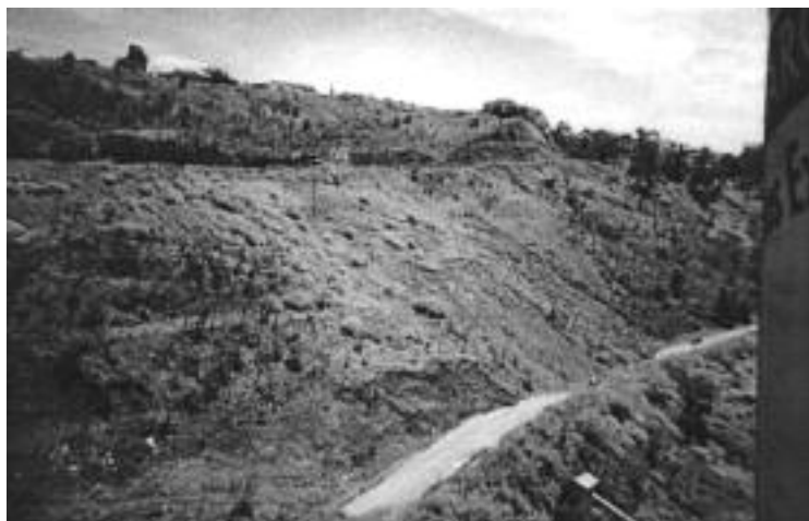
Fig. 9 – Vista geral do Talude Planetóides, exibindo cicatrizes de ruptura, e material escorregado na base, invadindo a rua.
