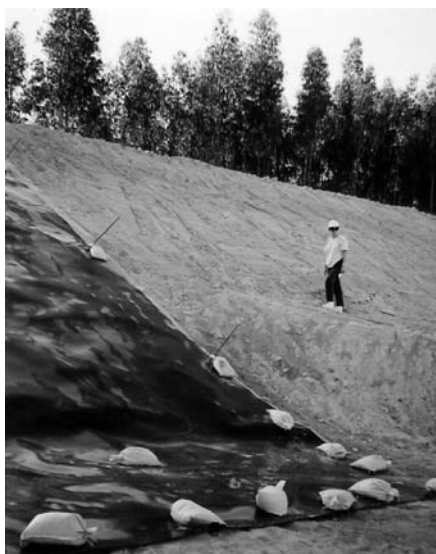
Fig. 4 – Estado da superfície do talude devido à exposição aos agentes atmosféricos.
