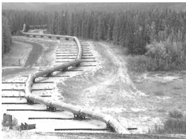
Fig. 38 –Atravessamento de uma falha pelo oleoduto do Alasca, dotado de isolamento basal mediante um sistema de patins [60].
