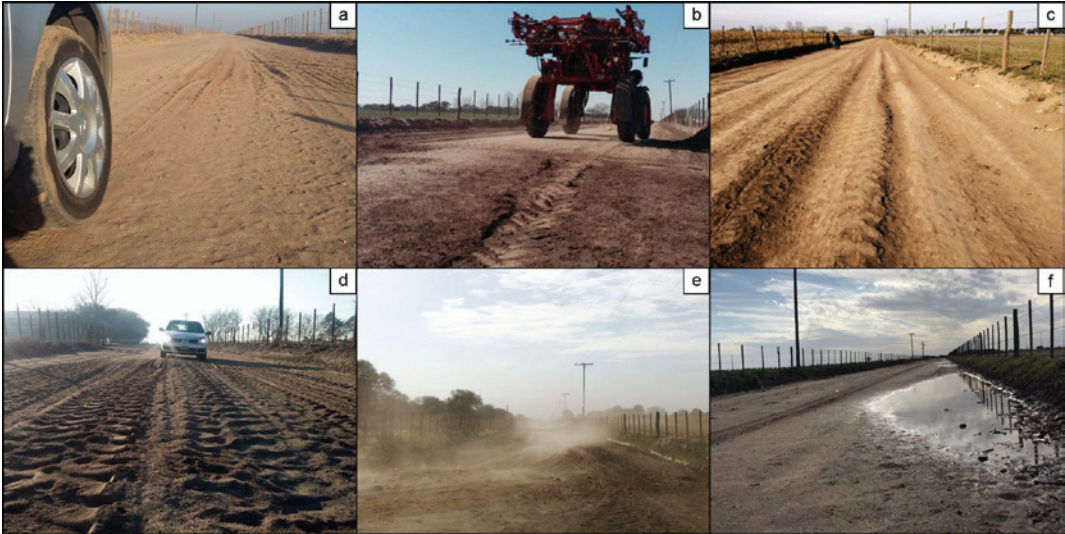
Fig. 1 – Patologías de subrasantes no pavimentadas limo-loésicas: a) suelo friable al tacto; b) falta de bombeo transversal; c) ahuellamiento excesivo; d) carcavamientos localizados; e) polvo en suspensión; y f) zonas inundables.
