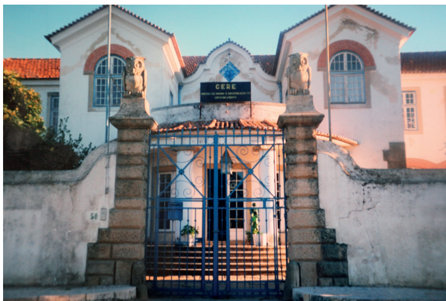
Fig. 3. Foto do álbum de fotografias do CERE, mostrando o portão e fachada da Escola Camões aquando da ocupação pela instituição, ainda com os mochos, mas já a demonstrar danos de infiltrações nas paredes.
