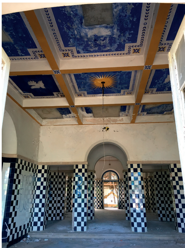
Fig. 7. Vista do primeiro espaço de entrada da escola, Sector 0.1 (vestíbulo), aquando dos trabalhos de limpeza, evidenciando marcas de vandalismo e deterioração, bem como restauros prévios ao teto em caixotão.
