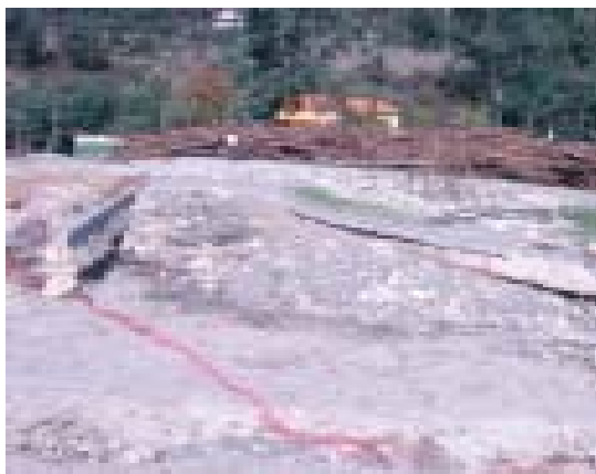
Fot. 25 - Detalhe da praia fluvial de Avô, após a destruição dos arruamentos e a deposição dos materiais abandonados. A figura humana e a casa servem de escala (16 de Julho de 2006) .
