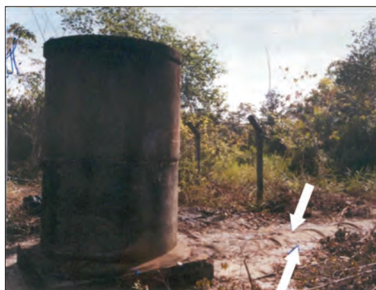
Fot. 1 - Rompimento da tubulação de concreto (Fonte: CPC, 2003a, modificado com o acréscimo da seta).
