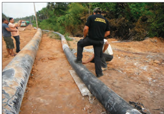
Fot. 14 - Perito do C.P.C. Renato Chaves, pesquisadores do LAQUANAM-UFGA, incêndio na vegetação e parte do mineroduto substituído (Fonte: Lemos, 2018).
