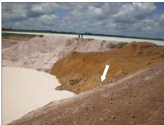
Fot. 9 - Estaca no ponto onde foi constatado microfissura na bacia de rejeitos n.º 3 (Fonte: Lemos, 2018, modificado com o acréscimo da seta).
