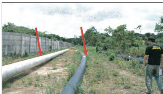
Fot. 16 - Tubulação em aço inox (esquerda) e em PEAD (direita) (Fonte: CPC, 2013).
