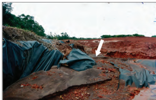
Fot. 3 - Lama vermelha sobre o talude da bacia de acumulação de rejeitos (Fonte: CPC, 2003a, modificado com o acréscimo da seta).
