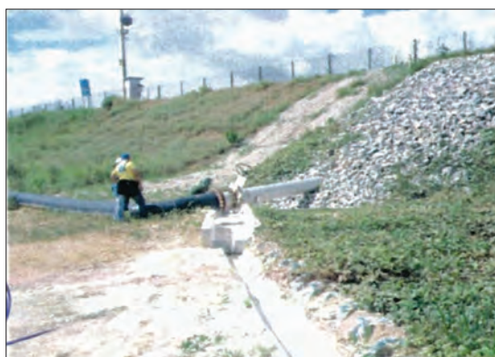
Fot. 17 - Filtro invertido no talude da bacia de rejeitos n.º 5 C, onde há reforço de pedras (Fonte: CPC, 2014).
