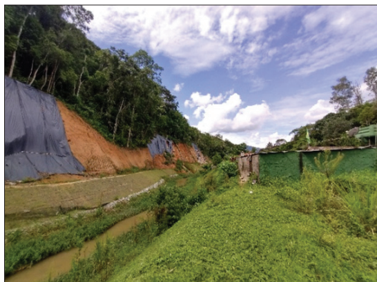
Fot. 8 - Planície do rio Cuiabá no Ponto 9, em 2023, na margem esquerda, com construção ocupada, encostas erodidas e obras de contenção (Fotografia de Rosângela Botelho, tirada a 23/01/2023).
