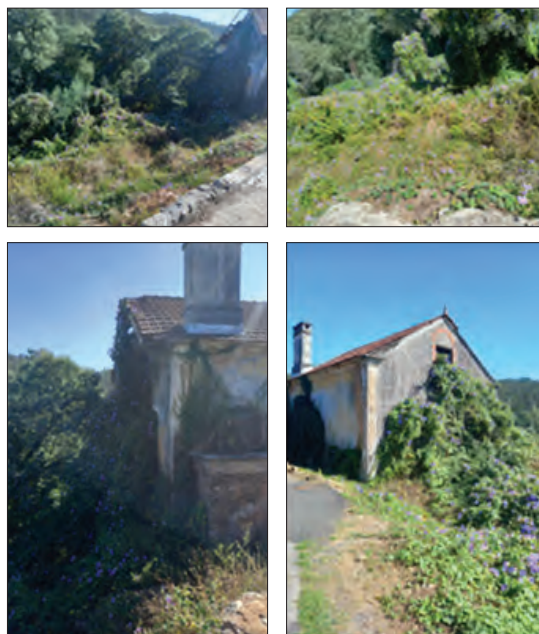
Fot. 3 - Casa com risco de incêndio - ausência de limpeza (Fotografia de Mário Talaia, tirada a 20/08/2024).
